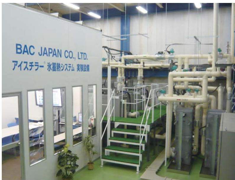
アイスチラー®氷蓄熱システム実験設備
