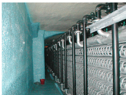
現場組立型アイステラ® 氷蓄熱コイル設置例
