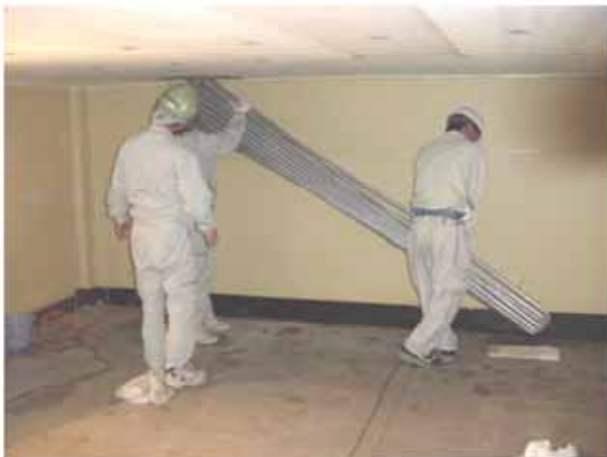
現場組立型ブライン方式アイスチラー ® 氷蓄熱コイルの部材搬入状況
